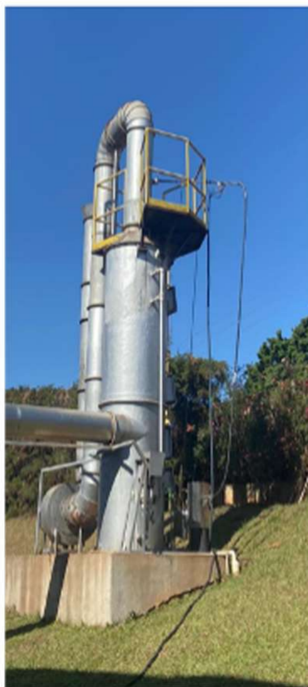
Lavador de gás - Fundição
